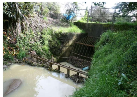
Photo: Maire Stream Stormwater intake
